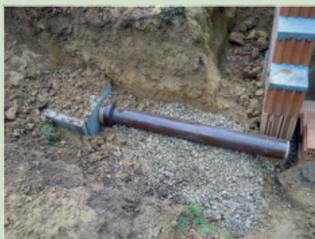
Abb. 5.2.2.5: Winterquartier rund 50 cm unter der Geländeoberkante (GOK) bestehend aus handelsüblichem Baumaterial. 18 Foto: Karl Schäffer, 21.11.2018
