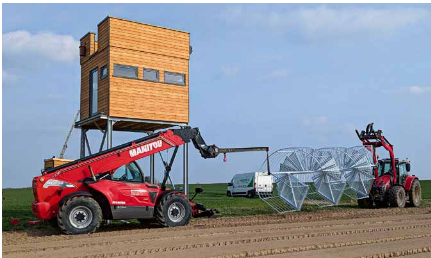
Abb. 2: Die Montage der Treppenanlage war eine Herausforderung und erforderte Präzisionsarbeit. Foto: Volker Tiemeyer
