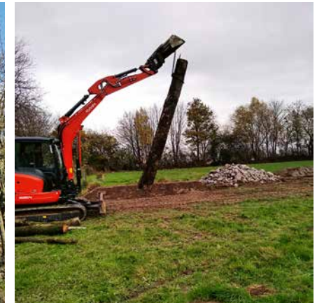
Abb. 8: Der Einbau der vier Meter langen Rotbuchen-Stämme war in Handarbeit nicht zu schaffen. Foto: Michael Schleef
