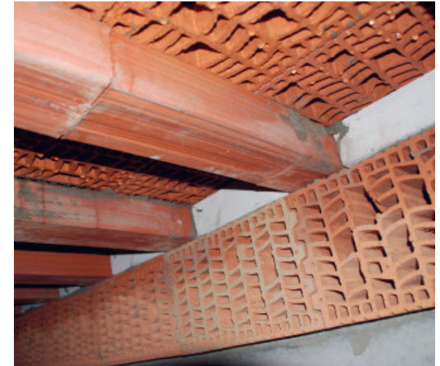
Abb. 4: Kondenswasser tropft von den Steinen der Decke. Eine hohe Luftfeuchtigkeit ist eine Voraussetzung für ein Winterquartier für Fledermäuse. Teilweise wurden die Steine übereinander gesetzt, um verschiedene Tiefen als Hangplätze anzubieten. Foto: Gerhard Hagensieker, 21.11.2018
