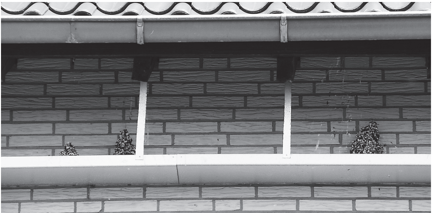
Abb. 5 Kottauffangbretter schützen die Hausfassade und ermöglichen dennoch einen ungehinderten Anflug der Mehlschwalbe. Ein wunderbar gelungenes Beispiel aus Melle-Mitte.
